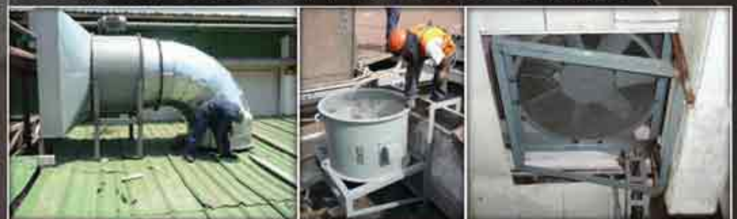
Sistema de ventilación y extracción de Planta
