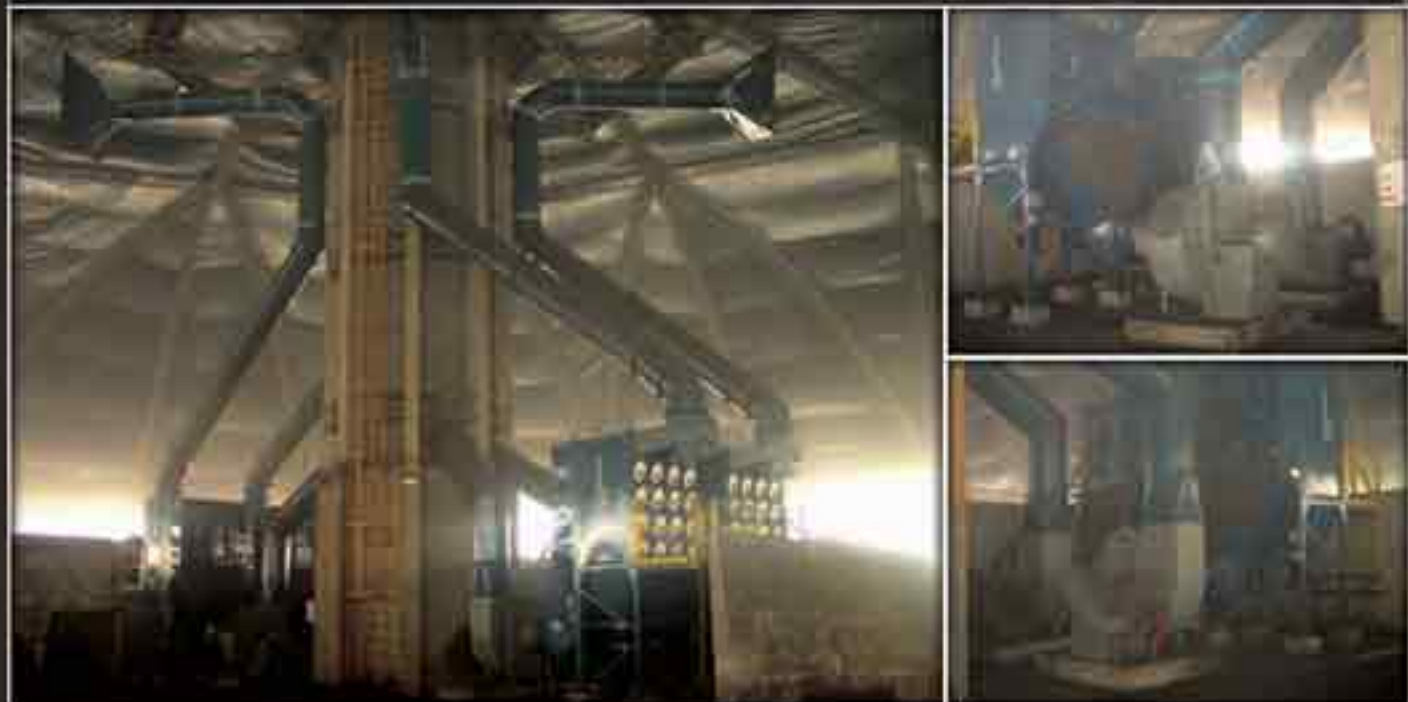
Sistema de ventilación de almacén de concentrados
