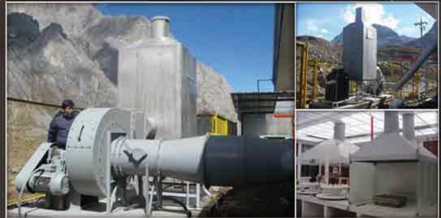
Sistema de neutralización de Gases y Polvos
