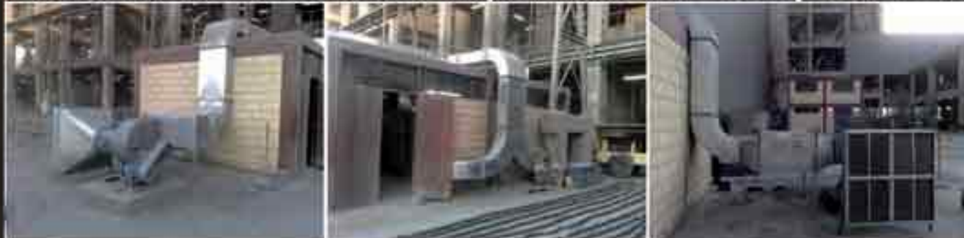
Sistema de Presurización para sala de compresores
