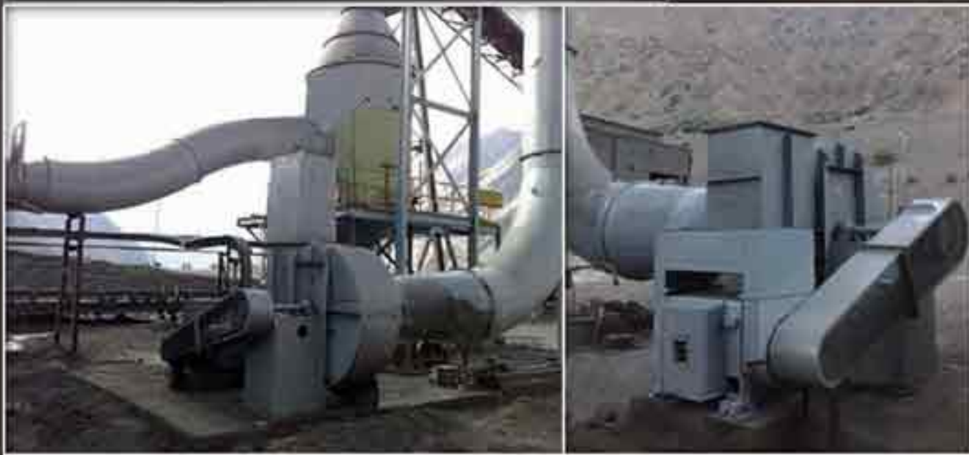
Sistema de extracción de polvo
