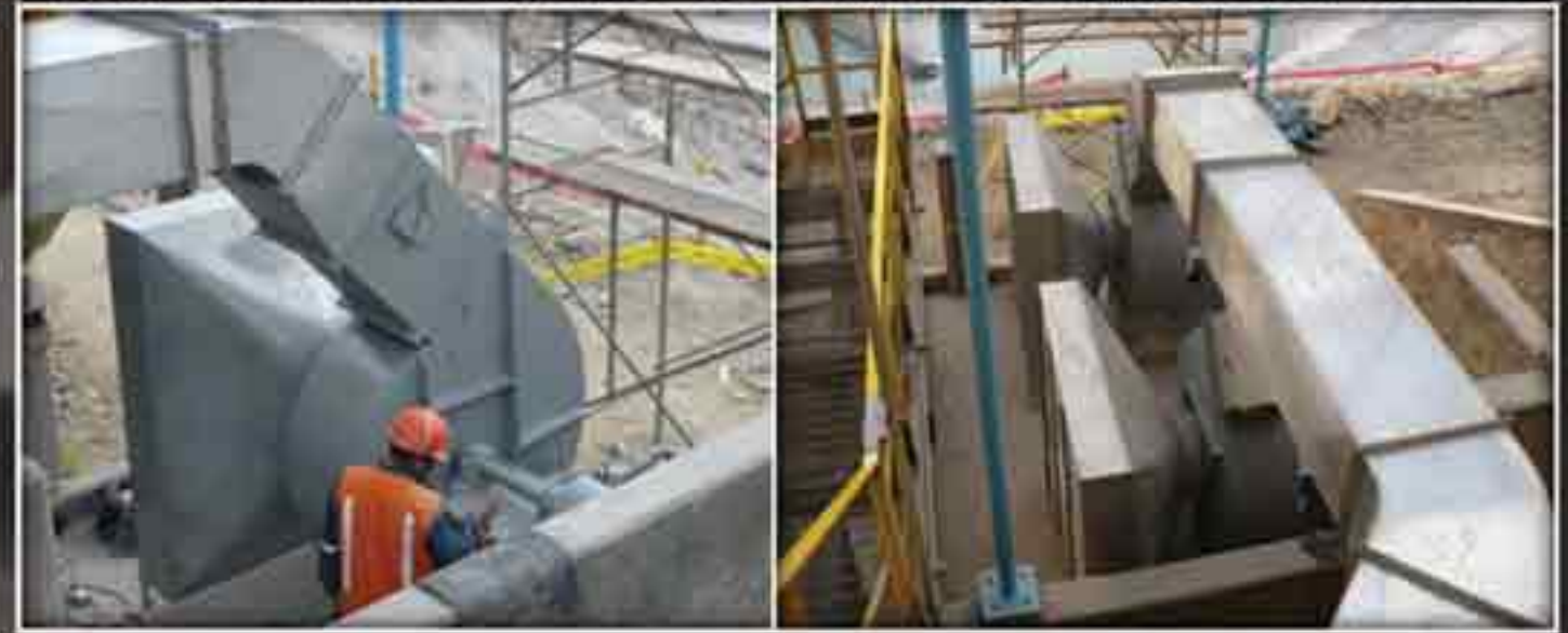
Sistema de ventilación de cuarto eléctrico en Planta
